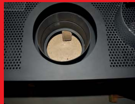
Popol a sadze sa usádzajú na vodorovných plochách šamotového obloženia. Prístup je možný len po zložení komínovej rúry.
